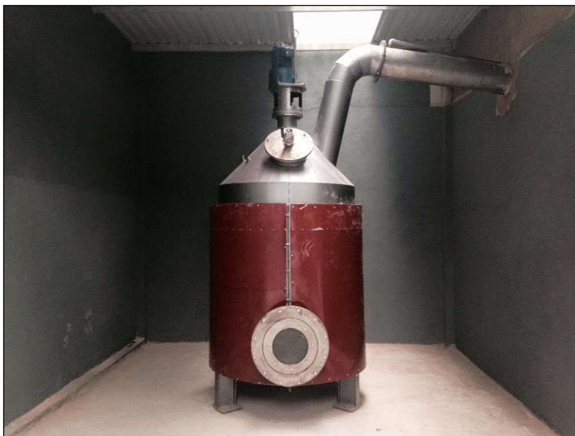
Hình. Hệ thống chưng cất dung môi (công suất 1.500 kg/h)
