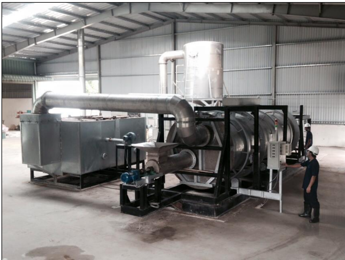
Hình. Lò đốt CTNH (công suất 1.500 kg/h)
