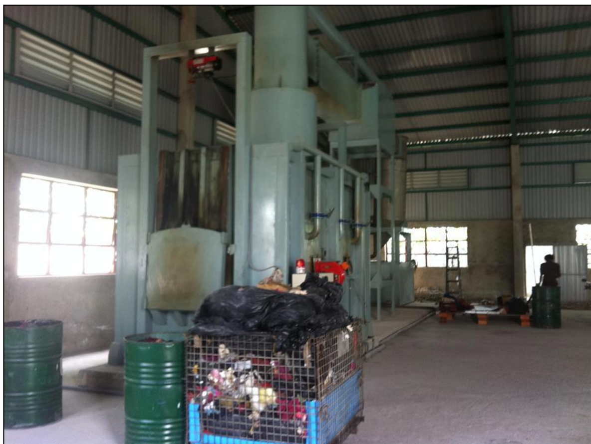
Hình. Lò đốt CTNH (công suất 100 kg/h)
