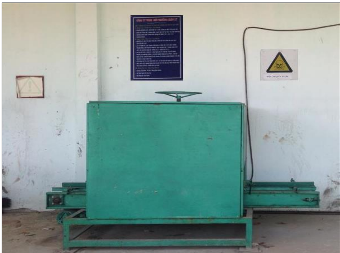
Hình. Hệ thống sơ chế ắc quy chì thải (công suất 100 kg/h)
