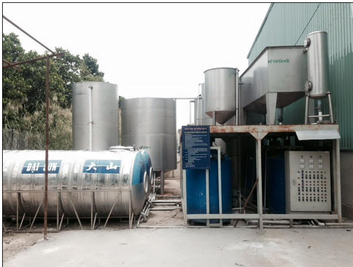
Hình. Hệ thống xử lý nước thải (công suất 50 m 3 /ngày)
